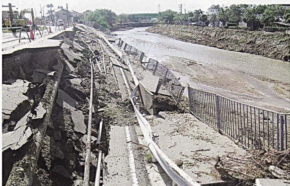
当時の被害状況
