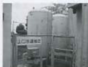
山口簡易水道
